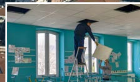
La rénovation énergétique passe par l'isolation et la rénovation de l'éclairage avec des LEDS
